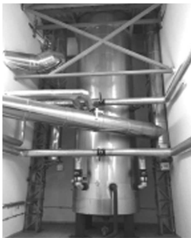
Fotografia 3. „Serce” kotłowni na biomasę (autor: W. Bieńkowska-Gołasa)
